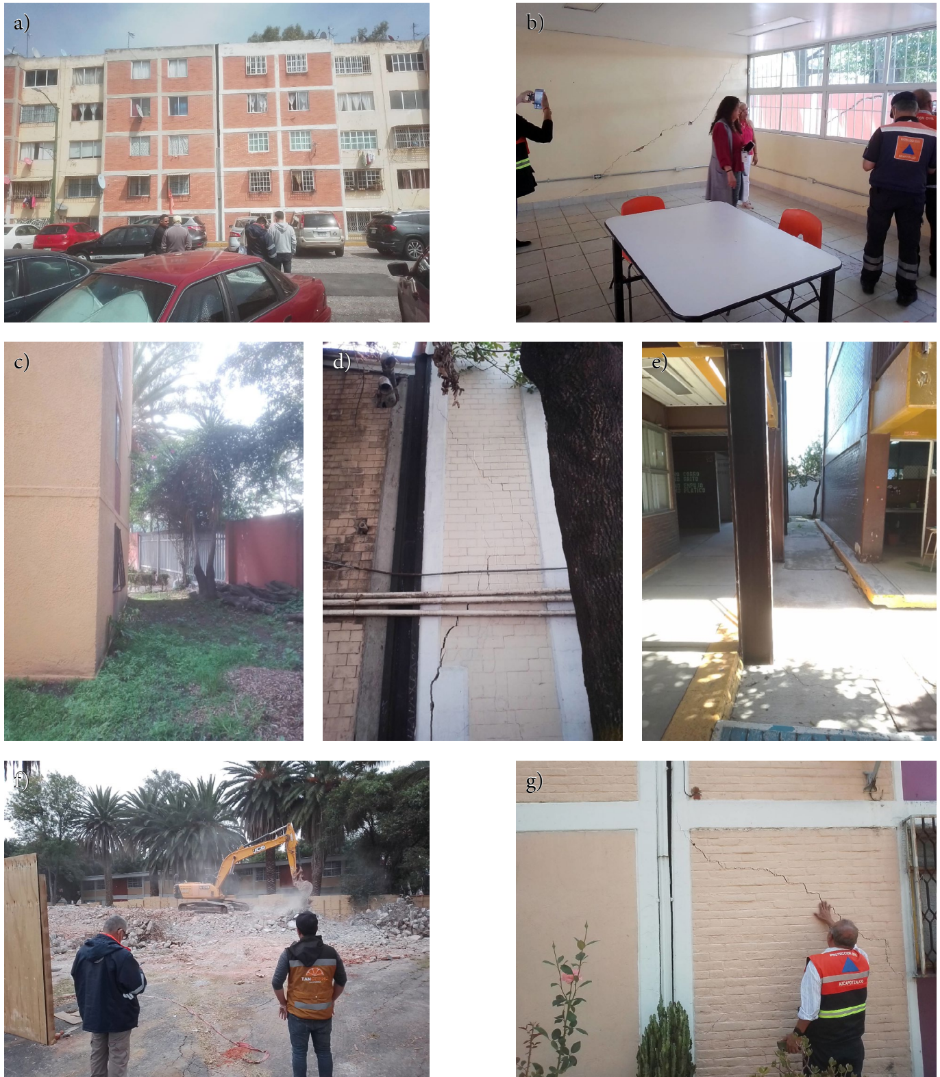
Figura 4. Daños en edificaciones: (a) Unidad Habitacional Manuel Rivera Anaya (UMR), separación de la parte superior entre dos edificios. (b) Centro de Capacitación para el Trabajo Industrial 1 (CEC), grietas en muro y barda, deformación en ventanas. (c) Unidad Ecológica Novedades Impacto (UEN), desplomo en uno de los edificios. (d) Escuela Superior de Ingeniería Mecánica y Eléctrica (ESI), grietas en muros y columnas. (e) Escuela Secundaria Técnica 98 (S98), a la izquierda, edificio inhabilitado por desplomo y deformación. (f) Internado Primaria 2 Ejercito Mexicano (PEM), edificio demolido por daño estructural. (g) Unidad Habitacional Cuitláhuac (UCU), fractura en muro.
