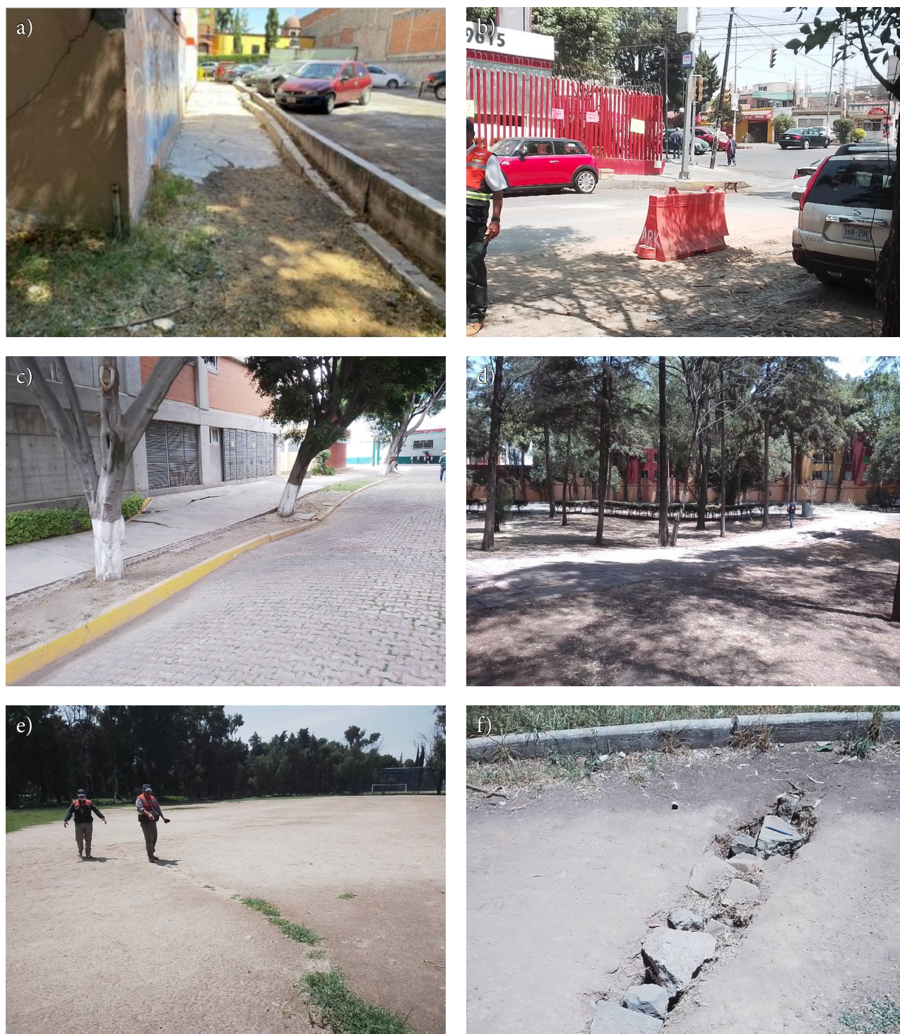
Figura 7. Hundimientos circulares y fracturas asociadas: “(a) Unidad Habitacional Pantaco (UPA), hundimiento y grieta de tensión en edificio. (b) Calzada Azcapotzalco-La Villa (VAV) y cerrada, hundimiento en la zona de daños en Centro de Capacitación para el Trabajo Industrial 1 (CEC) y Escuela Superior de Ingeniería Mecánica y Eléctrica (ESI). (c) Internado Primaria 2 Ejercito Mexicano (PEM), hundimiento en avenida interior. (d) hundimiento en Alameda Norte (ALM). (e) Deportivo Azcapotzalco (DAZ), grieta en el perímetro de un hundimiento incipiente. (f) ALN, porción de una grieta de forma curva y espesor de 25 a 35 cm.”
